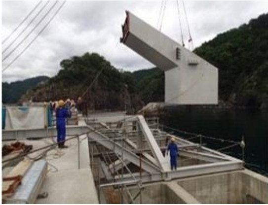
図1 4 ダクト・空気室の据付
